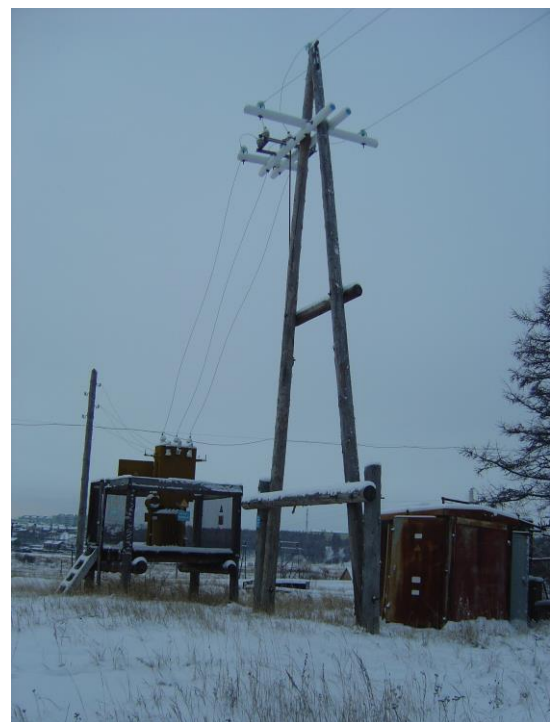
Рис.2. Фотография траверс и подтраверсников анкерной концевой опоры ЛЭП 6кВ.
